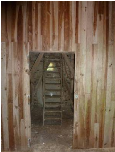
Avant travaux, la porte séparant le clocher du comble n'existe plus et laisse l'accès aux prédateurs
